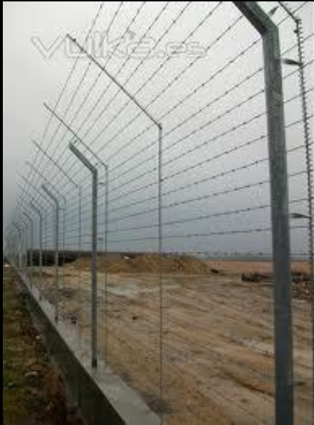
Protección pasiva: Valla metálica.
